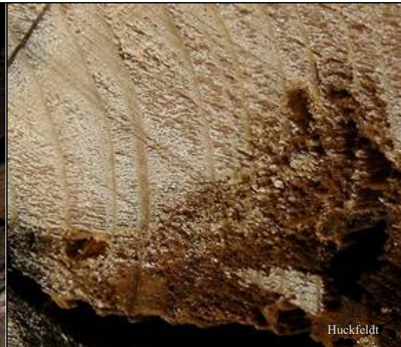
Abb. 2: Detail von Abb. 1: Günstiger Bereich zur Probenentnahme (gern können Sie auch mehr Material einsenden, im Zweifelsfall einen ganzen Balkenkopf).
