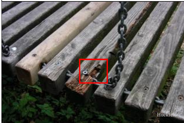
Abb. 3: Trittbalken mit Braunfäule. Probe aus dem Übergang vom gesunden zum zerstörten Holz entnehmen.
