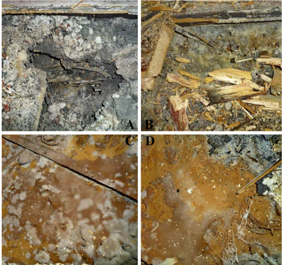
Abb. 1: Befallsbilder von Coniophora prasinoidea (vor Ort, frisch), 10.01.2013, Bochum-Wattenscheid (Nordrhein-Westfalen), an Nadelholz eines ungewöhnlichen Fußboden-Aufbaus: Decken-, Bodenfüllung ist Asche auf Lehmboden mit aufliegenden Schichten aus alten Dielen, Teppich, Spanplatten und Linoleum: A) Asche-, Lehmschicht; B) braunfaule Holzspäne und Mycelien unterhalb alten Dielen, Linoleum entfernt; C) Sporen auf Mycel und Fruchtkörper; D) Sporenstaub auf Strängen und Mycel. Fotos: P. v. D. HEIDE
